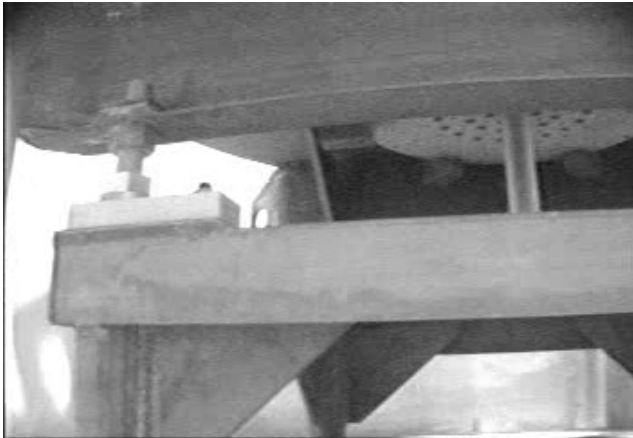
Figura 1: Imagem do suporte inferior do TRIGA IPR-R1 registrada durante a inspeção visual de 2006.
